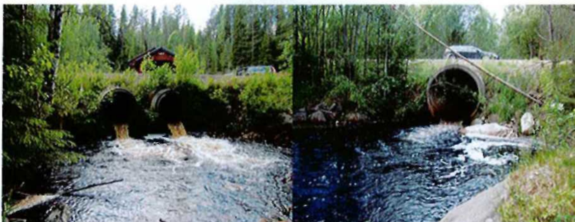
Foton. Vägtrummor i Tandövalla som innebär vandringshinder. Trummorna är både underdimensionerade och för högt placerade. Foton Klas Johansson
